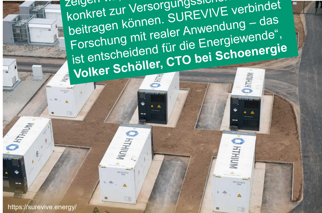
Batteriespeicher-Park in Föhren
