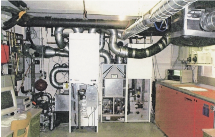
Abbildung 3: Teststand des Fraunhofer ISE für Lüftungskompaktgeräte im Solarhaus Freiburg
