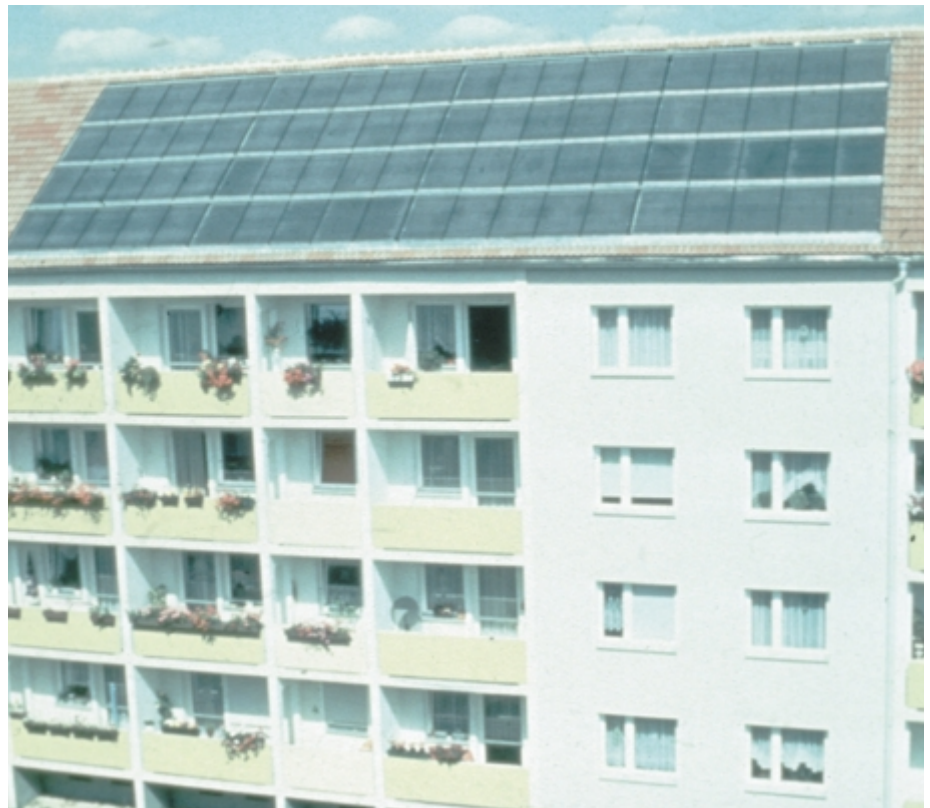
Abbildung 7: Solarkollektoren der Wohnanlage in Oederan
