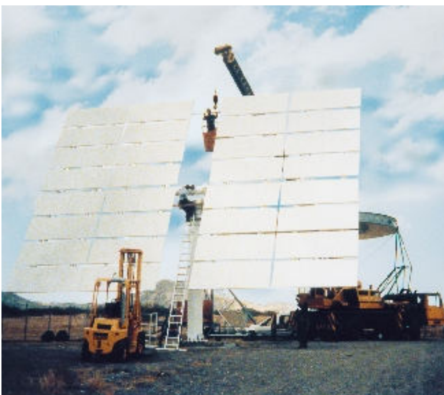
Abbildung 6: 100m 2 Glas-Metall-Heliostat GM100 auf der Plataforma Solar de Almería
