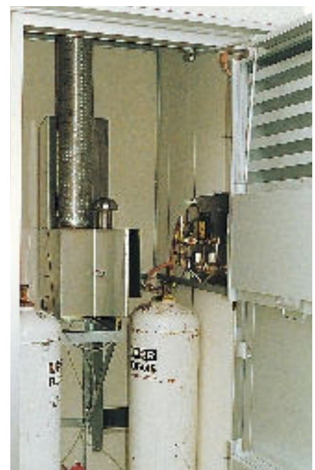
Abbildung 4: Separater Raum mit TE-Wandler und Gastechnik
