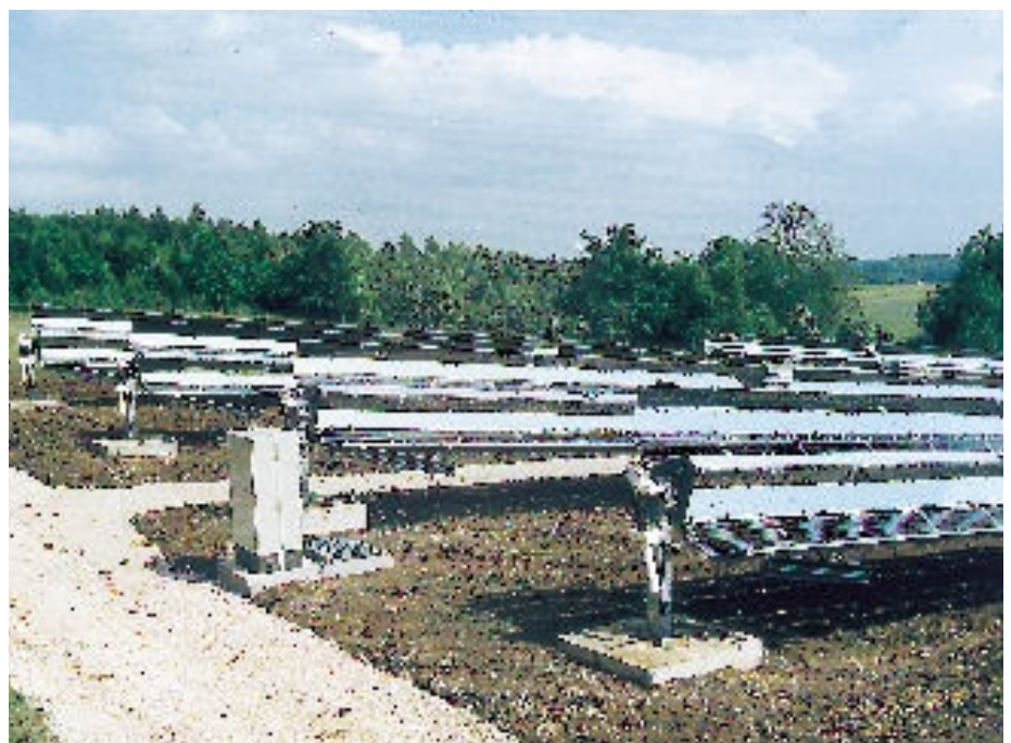
Abbildung 6: PV V-Trog Anlage auf dem ZSW Solartestfeld in Widderstall/Schwäbische Alb. Die Anlage besteht aus 9 Teilsystemen mit je 2,72 kW p installierter PV Modulleistung.
