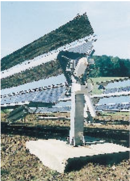
Abbildung 3: PV V-Trog mit Stabtragwerk. Der Träger mit Quertraversen hat eine Stützweite von über 14 m. Die Aperturfläche beträgt 75 m 2 (27,2 m Länge, 2,75 m Breite). Der thermohydraulische Antrieb sitzt am Rand der Struktur.
