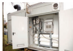
Methanisierungsanlage zur Erzeugung von regenerativem Erdgas, z. B. aus überschüssigem Windstrom
