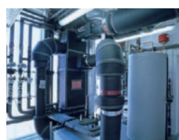
Anlagentechnik: Effiziente Energienutzung durch innovative Verteil-, Speicher- und Energieerzeugungskonzeptionen
