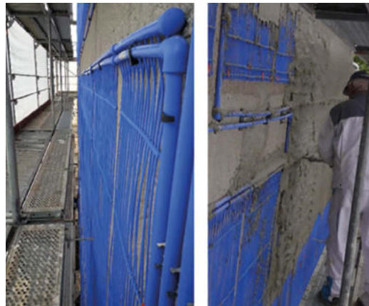
Abbildung 4 Außenliegende Wandheizung: Links: Aufbau der Flächentemperierung Rechts: Verputzung der Heizmatten während der Sanierung von außen
