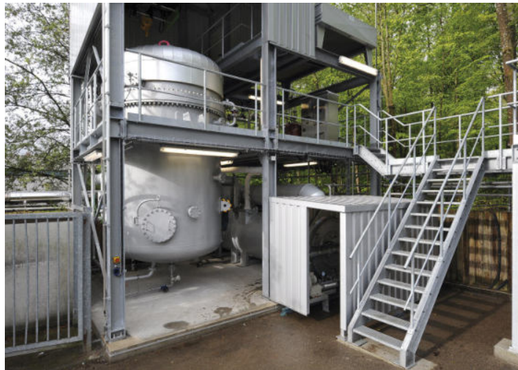
Abbildung 2 HOTREG Feststoff-Speicher-Testanlage des DLR
