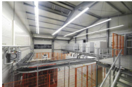
Abbildung 5 Prüflabor für Netzintegration im SysTec des Fraunhofer IWES: Oben: Leitwarte Unten: Innenansicht des Prüflabors
