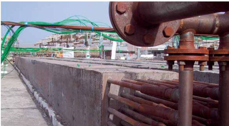
Abbildung 2 Feststoffspeicher vor Anbringen der Isolation
