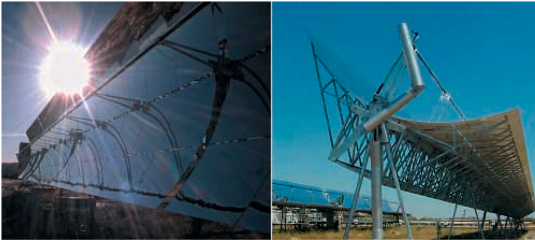
Abbildung 4 EuroTrough ET150 Parabolrinnenkollektor auf der Plataforma Solar, Spanien
