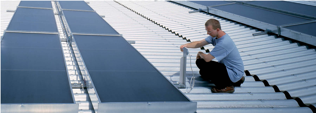
Solaranlage der IHK Freiburg © Fraunhofer ISE
