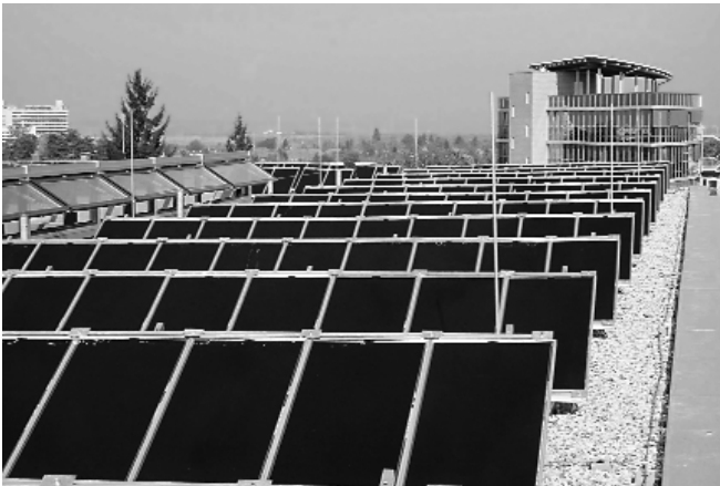
Abbildung 4 CIS-PV-Anlage „Schule Rotbäumlesfeld Ludwigsburg“ (290 Module, ca. 17 kW p )
