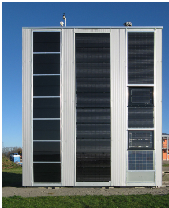
Abbildung 2 PV-Testfassaden am Fraunhofer IWES
