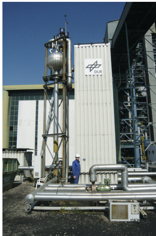
Abbildung 5 700 kWh Latentwärme-Pilotspeicher im Wasser/Dampfkreislauf
