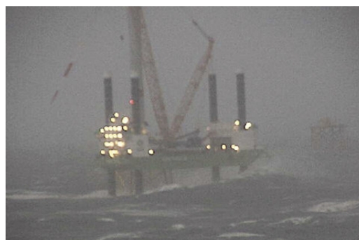
Abbildung 1 Der Windpark alpha ventus bei verschiedenen Wetterlagen – die extremen Umweltbedingungen offshore sind die größte Herausforderung © DOTI / BSH
