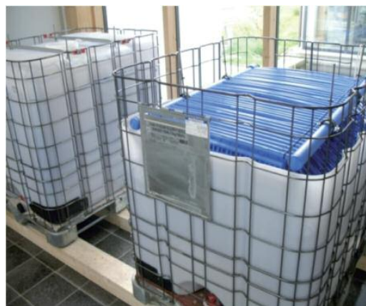
Latentwärmespeicher mit Calcium-Chlorid zur Rückkühlung eine Absorptionskältemaschine zur solaren Klimatisierung (ZAE Bayern)
