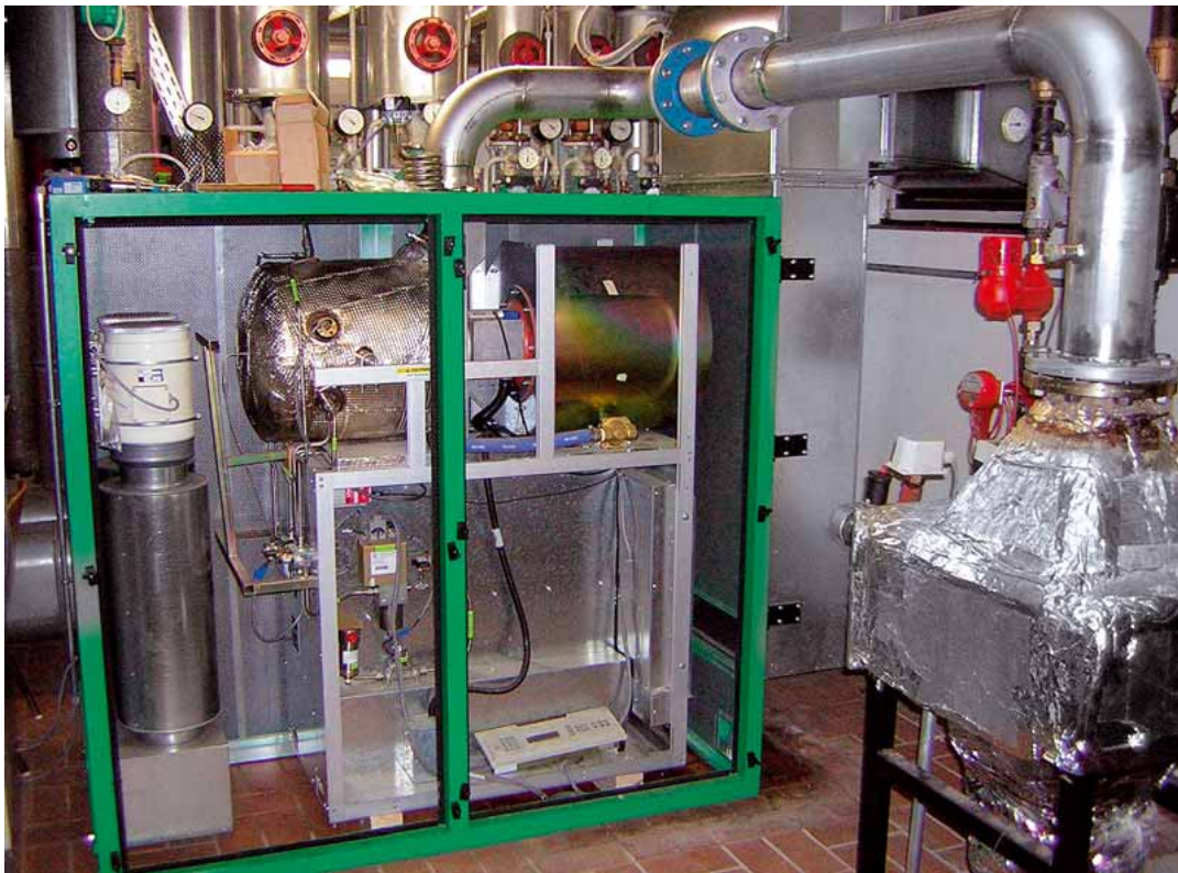
Abbildung 3 Pilotprojekt Biogasbetriebene Mikrogasturbine im ISET [8]
