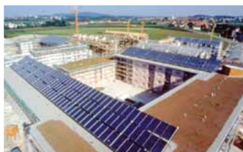
a Friedrichshafen-Wiggenhausen (1996) 380 Wohnungen, 4.050 m 2 Flachkollektor, 12.000 m 3 Heißwasser-Wärmespeicher
