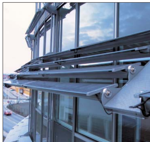
Abbildung 5 Einzelelemente der Photovoltaik-Tageslicht-Fassade am Verwaltungsgebäude Wirtschaftshof Linz.
