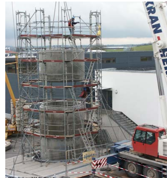
solare Nahwärme – 100m 3 Pufferspeicher
